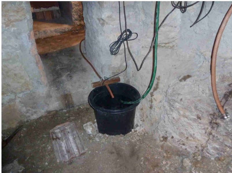
Abwasser im Keller
